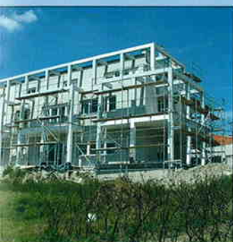
, Šestine, Zagreb ADORG d.o.o. Lučko rbane vile od ukupno 1.900,00 m 2 vršetak radova - lipanj 2005.
