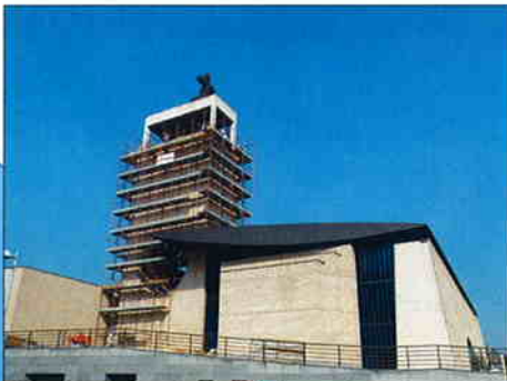
IZVEDBA FASADNOG OBLOŽNOG ZIDA ZVONIKA I UREĐENJE KATA NA SVETIŠTU SVETA MATI SLOBODE Zagreb Investitor: Župa Duha Svetoga, Zagreb Predviđeni završetak radova: prosinac 2005.
