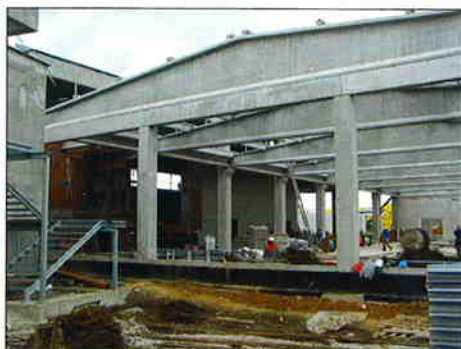
PROIZVODNA GRADEVINA ELEKTRODA ZAGREB, Zaprešić Investitor: Elektroda Zagreb d.d. Površina: 7.061 m 2 šetak radova: srpanj 2006.
