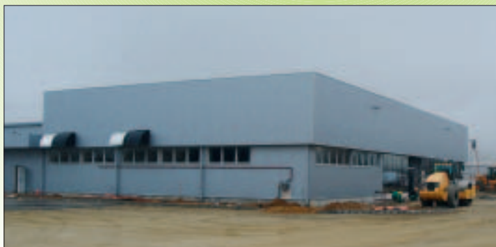
IZGRADNJA ROBNOG CENTRA KTC, PRAONICE ZA AUTOMOBILE I DOGRADNJA POSTAJE ZA OPSKRBU PRIJEVOZNIH SREDSTAVA GORIVOM, VIROVITICA Investitor: KTC d.d., Virovitica Površina: 3.464,00 m 2
